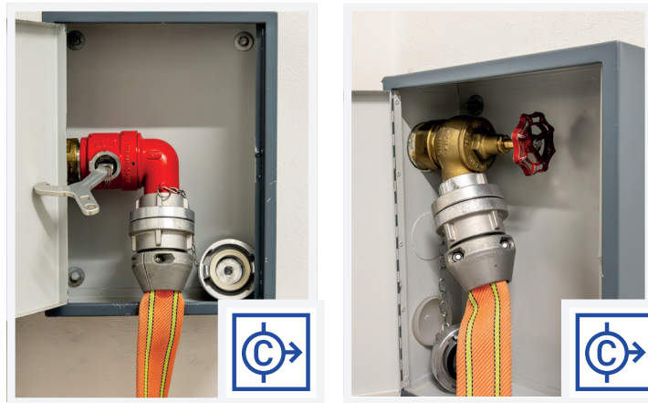
Entnahmestelle: DIN-Sechskant-Öffnung z. B. mit Feuerwehrbeil, Hydrantenschlüssel Typ B, Minikupplungsschlüssel möglich
